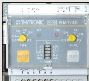
INTERRUTTORE DIFFERENZIALE EARTH FAULT BREAKER
